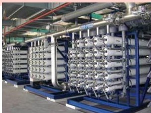
例子 污水处理技术 - 反渗透系统
